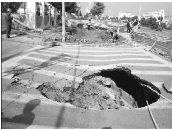
坍塌路面已部分回填 通讯员 叶方龙摄
