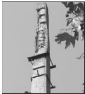
电线杆水泥已掉落一大半 快报记者 王冕 摄
