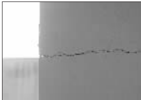
一米多长的墙缝
