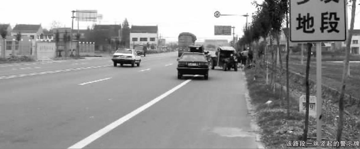
该路段一端竖起的警示牌
