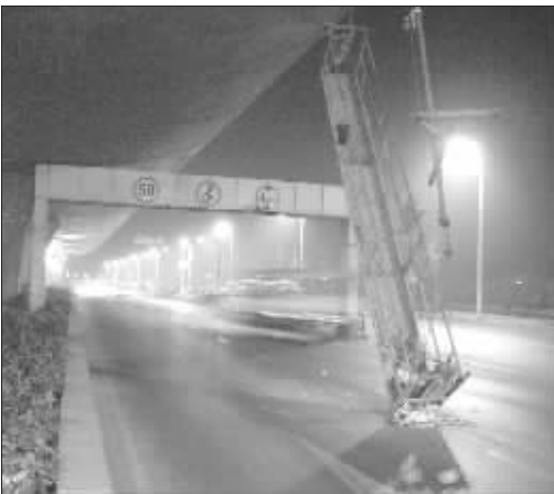
吊篮砸在桥下路面上
