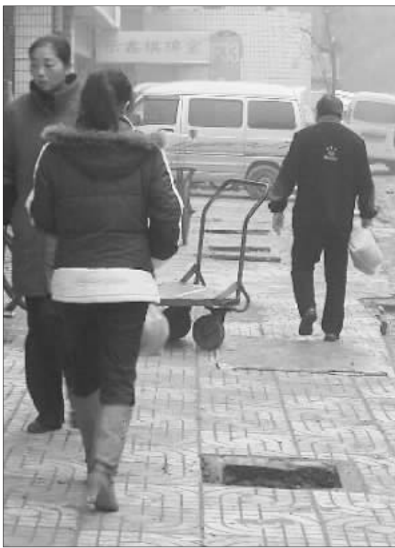
人行道上,十几个窨井盖被碾碎 见习记者 李彦摄
