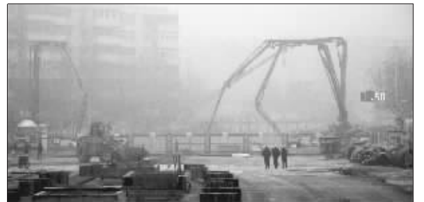
南京新模范马路快速改造工程隧道主体结构即将竣工,工作人员昨天正在忙着回填路面。工作人员称,预计1月底新模范马路将恢复路面通车。 快报记者 翁叶俊 摄
