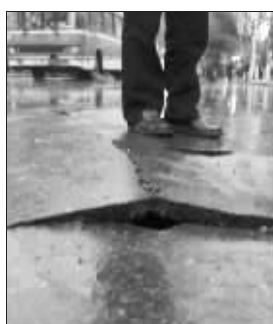
被自来水冲坏的地面 快报记者 薛林 摄
