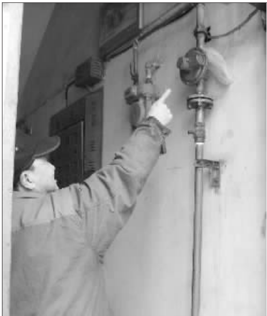
漏气的阀门 见习记者 李彦 摄
