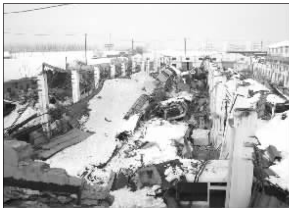
金龙客车厂厂房被大雪压塌 (图片由保监局提供)
