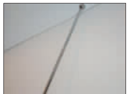
专家指出顶角线开裂
