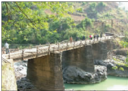
剧组在这座向阳桥上搭建的廊桥发生坍塌
