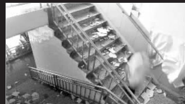
成都一家医院墙面被震坏
