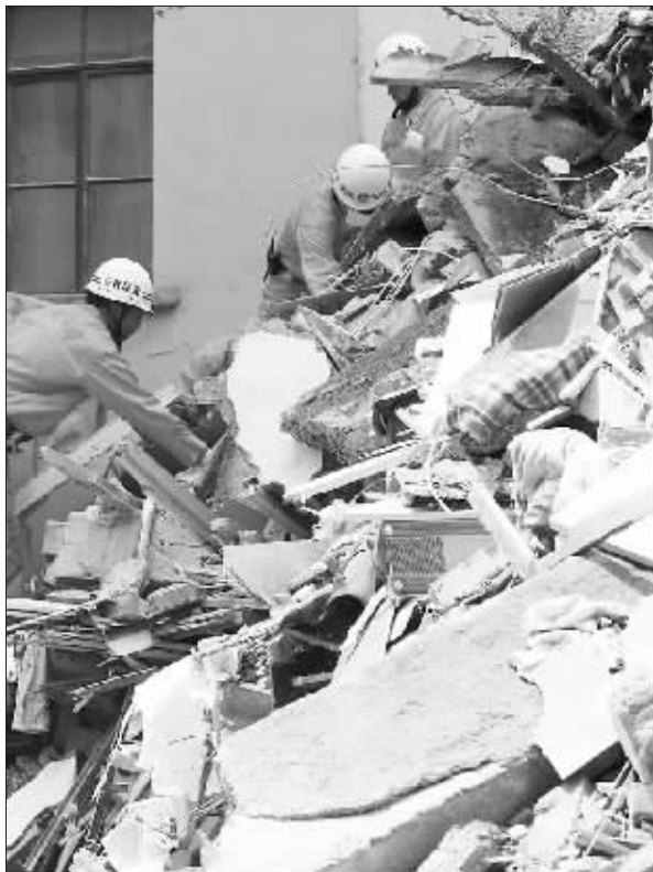
5月14日,来自贵州的消防救助队员在倒塌的废墟堆上搜寻幸存者。新华社记者 李明放 摄
