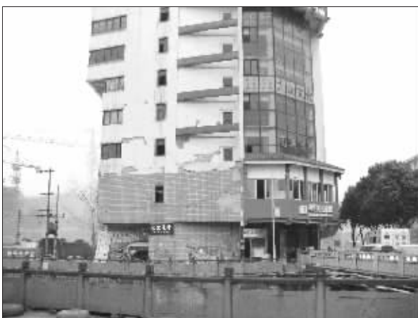
都江堰一幢大楼被震裂
