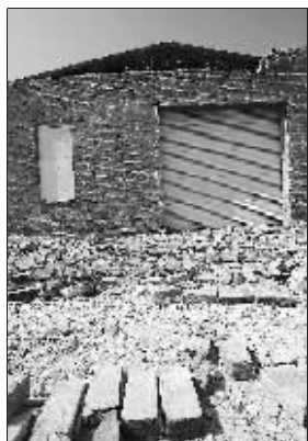
地震中一所老房子的墙受到损坏 新华社/法新
