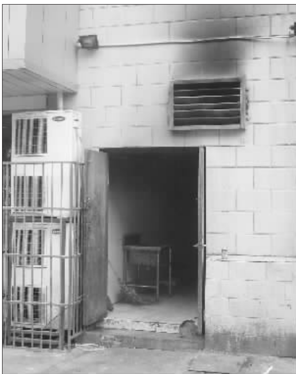
茶楼厨房排气口外墙壁被熏黑一片
