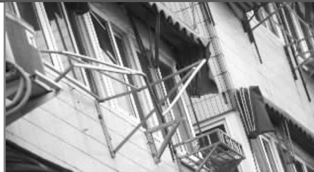
楼下居民阳台的晾衣架被砸弯 快报记者 唐伟超 摄
