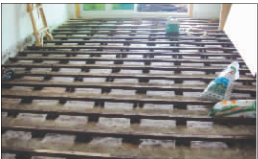
客厅地板下的地龙骨全都被水浸泡了
