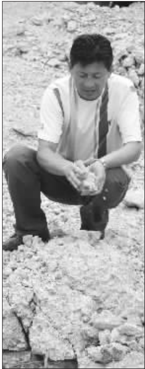
水电站使用不合格的混凝土一捏就碎。
