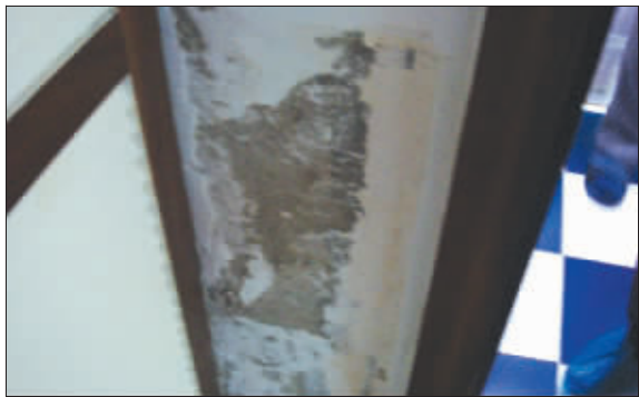
受潮后被扒开的墙面
