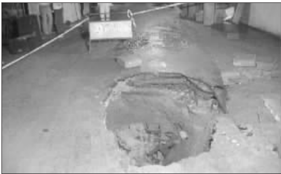
自来水管爆裂,地面被炸开一个大口子 快报记者 李彦 摄
