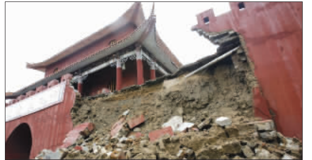
在暴雨的袭击下,三亚古城墙出现坍塌
