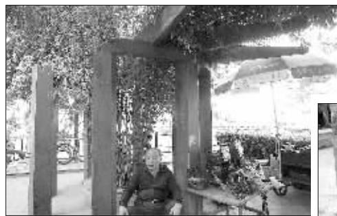
▲这亭子哪还有亭子样? 破败的亭子柱脚
