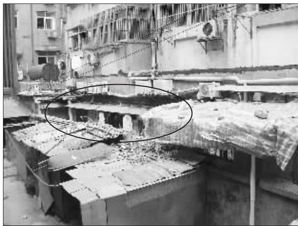
图中圈内的违建已被拆除
