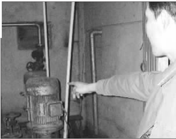
居民就靠这个锈迹斑斑的水泵供水
