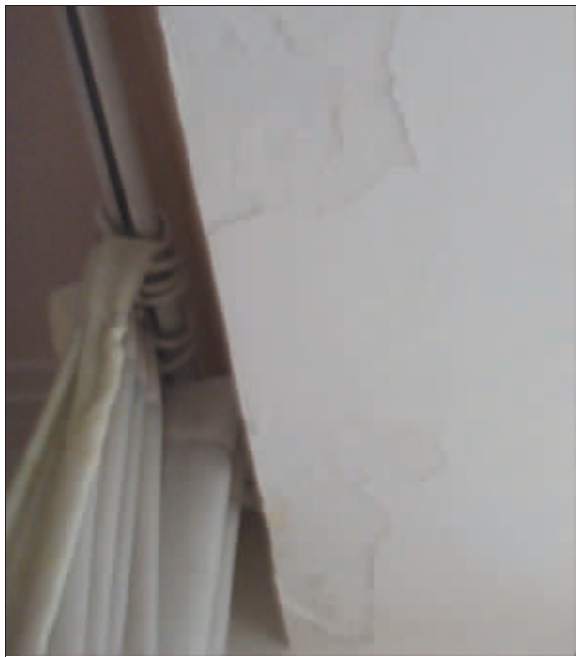
原墙体粉刷层没铲除,导致墙体开裂
