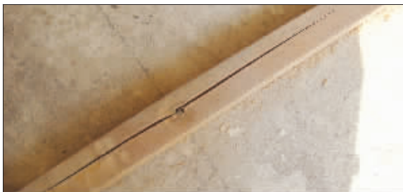
地龙骨严重开裂
