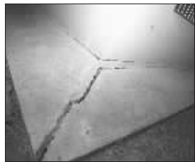
居民楼出现裂缝
