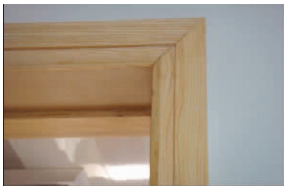
门套裂缝严重
