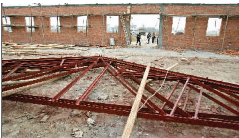
钢梁倒塌,造成两死四伤的惨剧 快报记者 施向辉 摄
