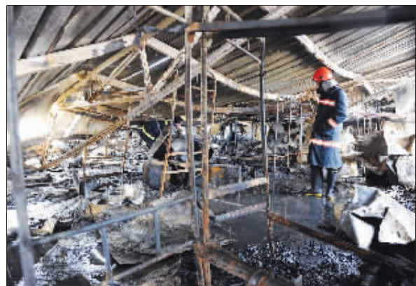
12月4日,消防人员在清理火灾现场 新华社记者 李紫恒 摄
