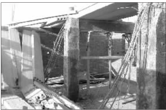
垮塌事故现场
