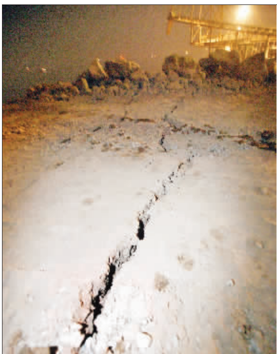
堤岸上出现巨大裂缝
