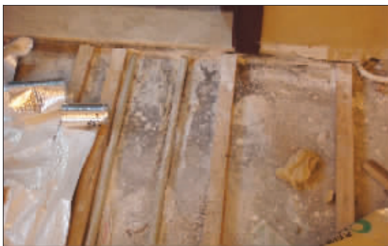
主卧水管漏水,令业主心烦,让工程丢分
