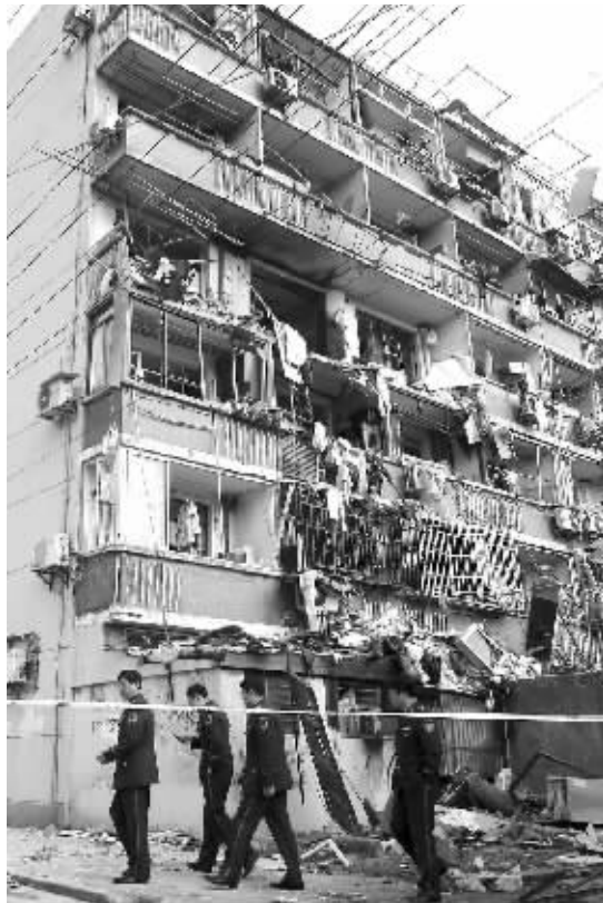
12月26日,发生爆炸事故的居民楼 新华社记者 裴鑫 摄
