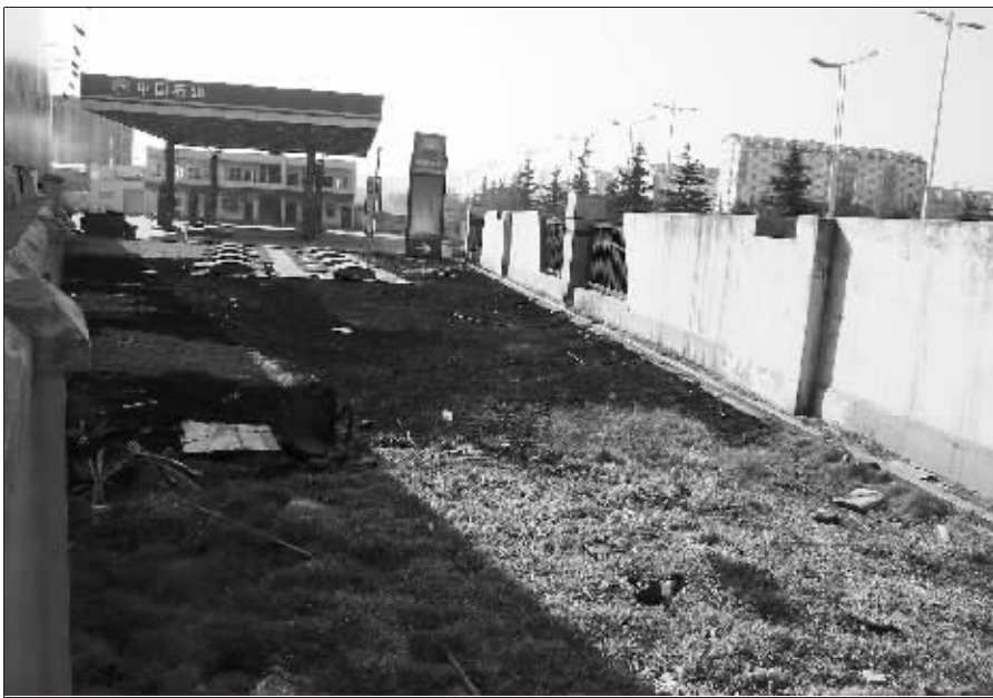
被烧焦的草坪离输油口已经很近
