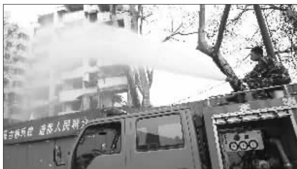
快报昨天B4版报道《路边拆大楼 让人灰头土脸》一文后,施工单位特意请来消防车到江宁路南端的施工现场喷水降尘,给周围居民和行人营造一个良好的环境。快报记者 顾炜 摄
