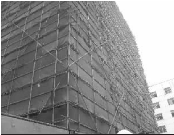
发生事故的工地
