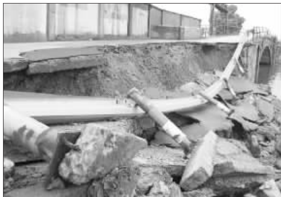
坍塌的路面现场(图二)
