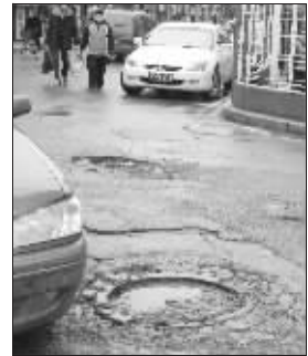
坏了的窨井盖无人修
