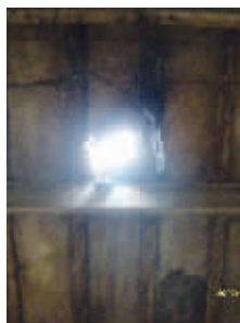
屋顶被砸出个洞
