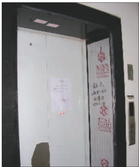
出事的电梯已停用,门上贴着物业公司的通知。
