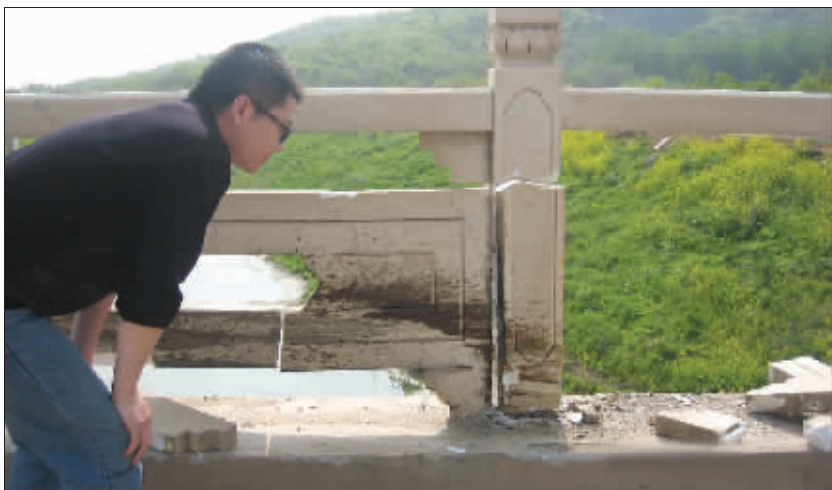
事故现场,桥护栏被撞断,留下一片血迹
