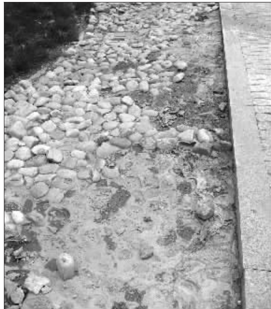
鹅卵石已出现大片脱落
