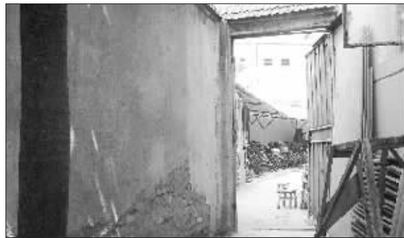
去年出新为啥遗漏了这面墙?
