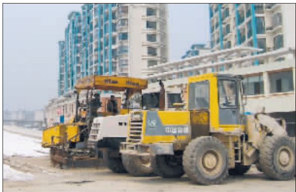
五星家园旁的建筑工地(左图)和金匮苑门口的立交桥建筑工地 薛晨摄
