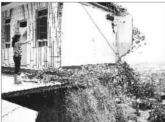
第6间病房已坠下土崖,只剩墙上空调 李华摄
