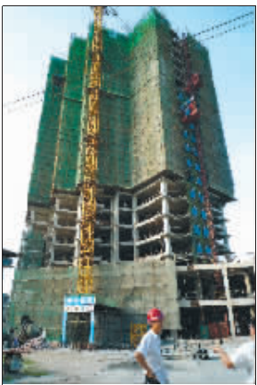
这是发生丑闻的武昌中心城区余家头小区三期B座住宅楼(6月19日摄)。 新华社记者 沈 摄
