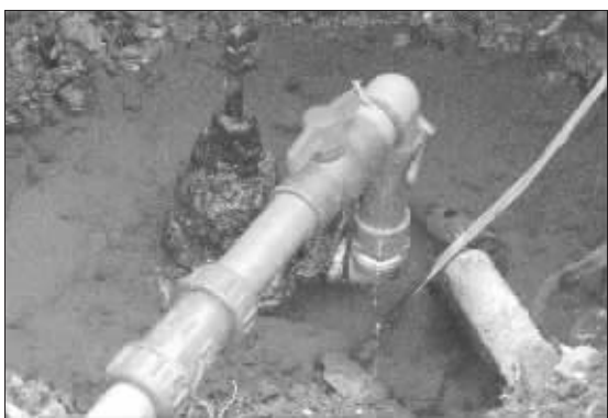
一些老房子的水管采用的是镀锌材料易生锈腐烂,最好换掉
